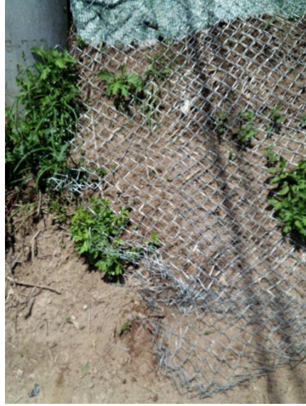
[No.13] 11:13 縁石補修 ネット破損
