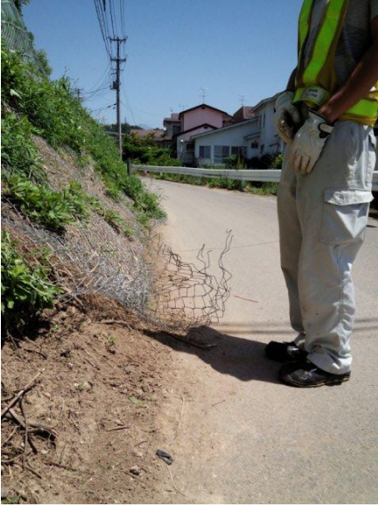
2018年05月25日 金曜日 [No.12] 11:12 縁石補修 ネット破損
