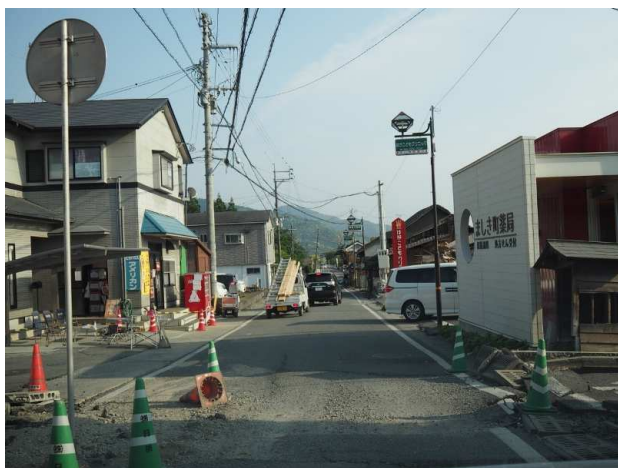
写真3 益城町の道路被害
